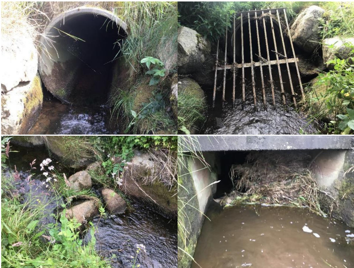
Figur 63. ØV: Vandringshinder 1, rør med lav vannsøyle ved lav vannføring. ØH: Vandringshinder 2, rist med 10,5 cm spalteåpninger. Denne er tilnærmet vandringsstengsel for større gytefisk. NV: Vandringshinder 3, utraste blokker som danner hinder ved liten vannføring. NH: Vandringshinder 4. Øvre del av bred kulvert hvor ansamling av materiale periodevis kan utgjøre vandringshinder.
