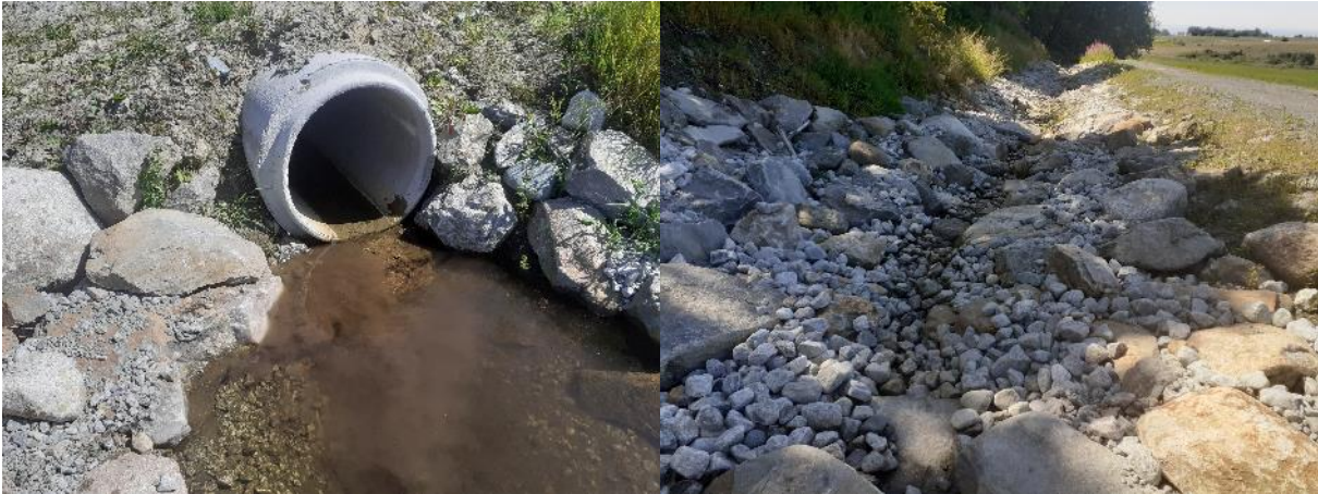
Figur 35. Venstre: Rør med kun 2 cm vann utgjør vandringshinder ved lav vannføring (sone 11). Høyre: Stryk i sone 15 var helt uten vann under befaringen.
