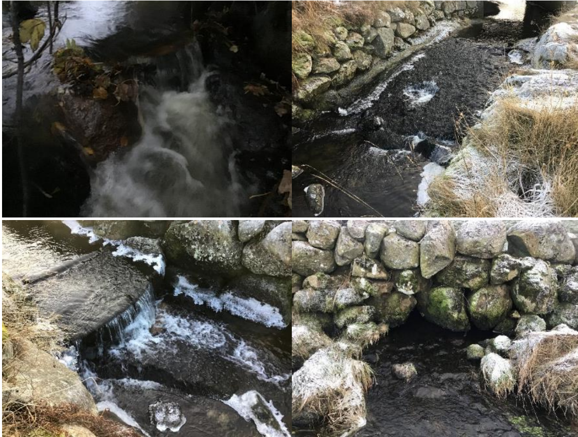
Figur 128. Vandringshinder 1-4 vist fra øvre venstre. De to sprangene til venstre (1 og 3) var begge rundt 40 cm ved lav vannføring. Betongstruktur øverst til venstre (2) har lav vannsøyle ved liten vannføring, og er relativt bratt (80 cm fall på 5 m). Steingard/steinfylling (4) nede til høyre er over 4 meter bred, og er vurdert å utgjøre et vandringsstengsel. Det er ikke vist bilder av vandringshinder 5 og 6.
